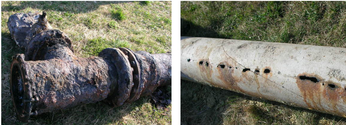
Abbildung 2: Zerstörtes Be- und Entlüftungsventil am Hochpunkt; Korrosion am Gussrohr, Pumpleitung DN 300 mm, Länge 8.500 m; nach ca 16 Betriebsjahren
