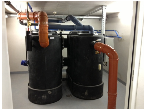
Abbildung 4: Fettabscheider Nenngröße NS7 in Wien 1; Aufstellung in einem adaptierten Kellerraum mit direkter Entlüftung über Dach und einer Saugleitung zur Entleerung in die Hauseinfahrt
