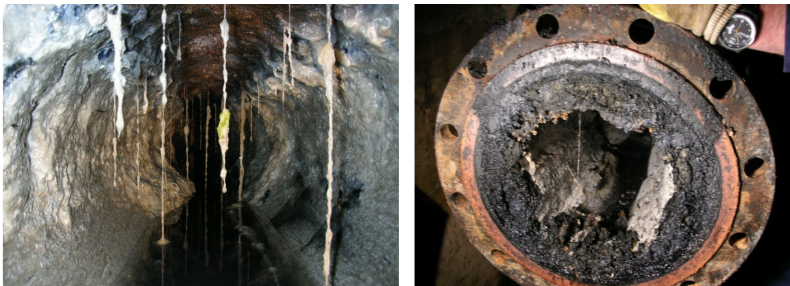
Abbildung 3: Ablagerungen und Sielhautschicht in einer Pumpleitung; DN 300 mm, Länge ca. 8.500 m; nach ca. 16 Betriebsjahren
