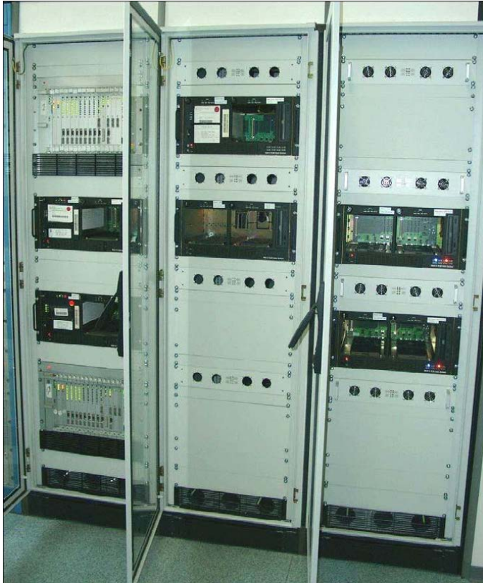
Abb. 2-5: Der Korrelator am Max-Planck-Institut für Radioastronomie, Bonn, Deutschland. Racks mit (v.l.n.r.): zwei Station Units (SU) + zwei Mark 5A, zwei Mark 5A + Platz für correlator interface boards (CIB) sowie zwei Mark 5B + Platz für CIB. (Foto aus Alef et al., 2007)
