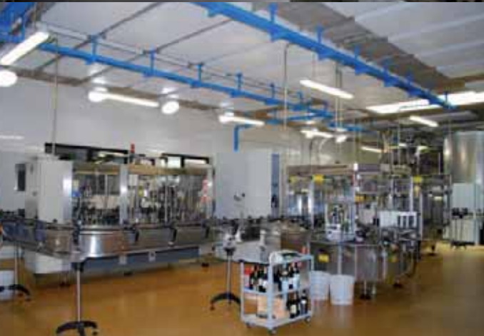
Abb.38: Abfüllanlage Weinkellerei Tramin
