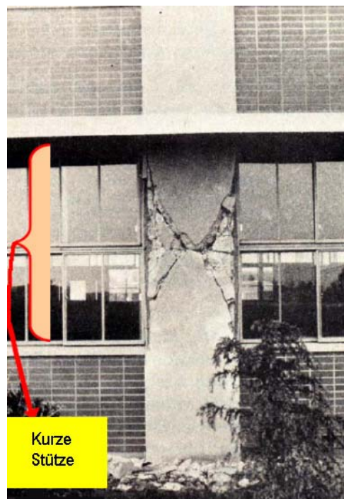
Bild 168: Kurze Stützen durch teilweise Ausfachung mittels Mauerwerk, entnommen aus [140]
