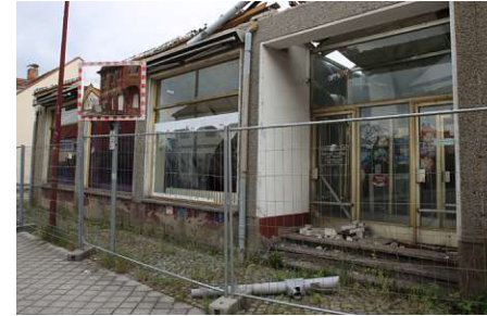
Abbildung 11: Sanierungsbedürftiges Gebäude, eingeschlagene Fassade in Welzow, Eigene Abbildung.
