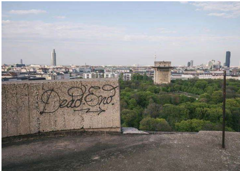
Abb. 71 Beschädigte Absturzsicherung auf der Terrasse - 11. Stock
