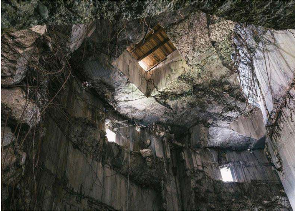
Abb. 67 Eingestürzte Zwischendecken in den oberen Stockwerke
