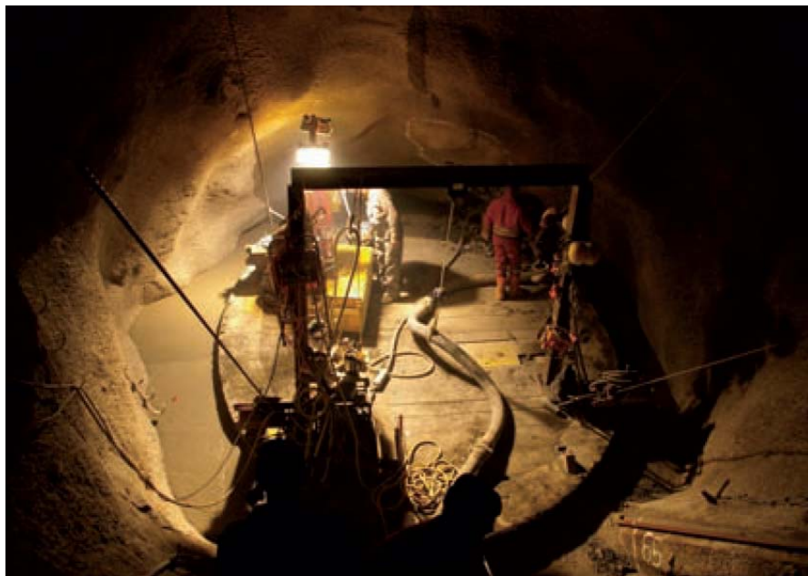
Abb. 16 Untertage Schachtverkleidung mit Neigung 49^\circ [2.35]
