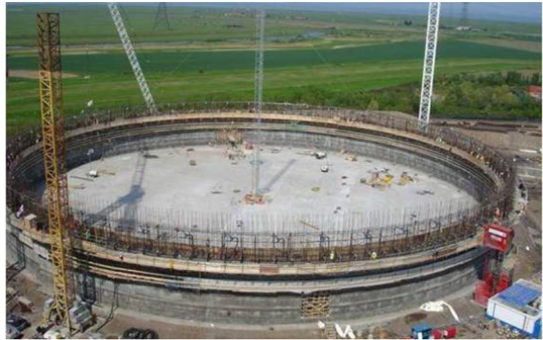
Abb. 9 Flüssigerdgasbehälter mit Durchmesser 90 m [2.24]
