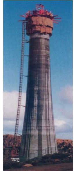
Abb. 72 Aufzug an dem Telekom Turm in Tasmanien. Die Höhe beträgt 90 m [2.22]
