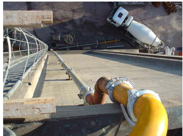
Abb. 73 Rohrleitung für Pumpbeton [2.41] (110 m hochgepumpt, Diamantmühle, Hamburg)
