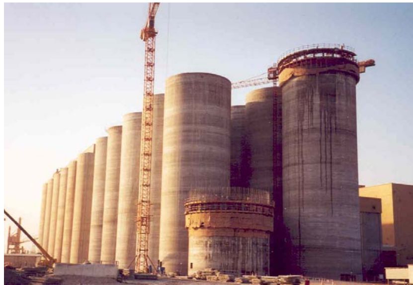
Abb. 8 Siloanlage in Jebel Ali, VAE (Vereinigte Arabische Emirate) [2.19]
