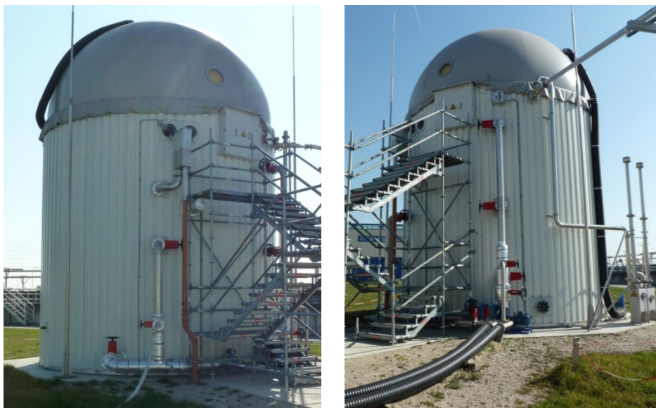
Abbildung 55: Faulbehälter; links: Entnahme und Überlaufkasten; rechts: Zulauf, Gasleitung (Aufnahmedatum: 11.03.2014)
