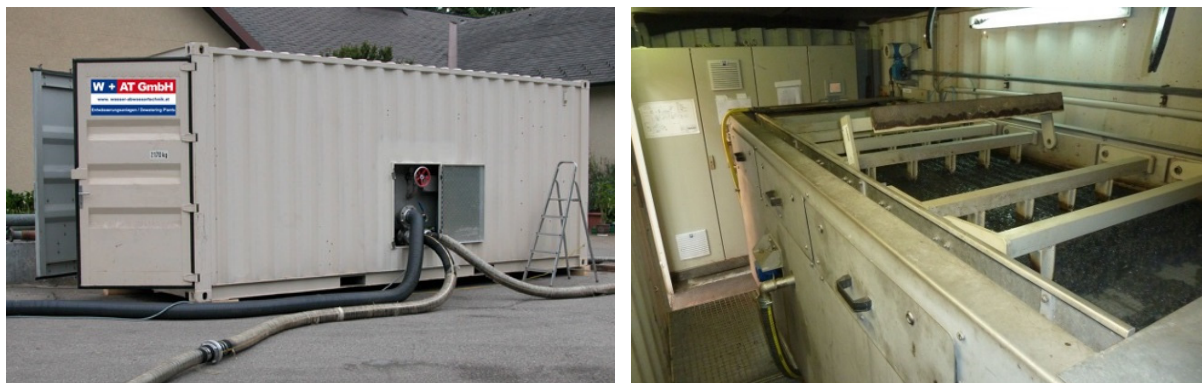
Abbildung 50: MÜSE (Maschinelle Überschussschlammeindickung); links: Außenansicht des Containers; rechts: Innenansicht Seihband und Schaltschrank)
