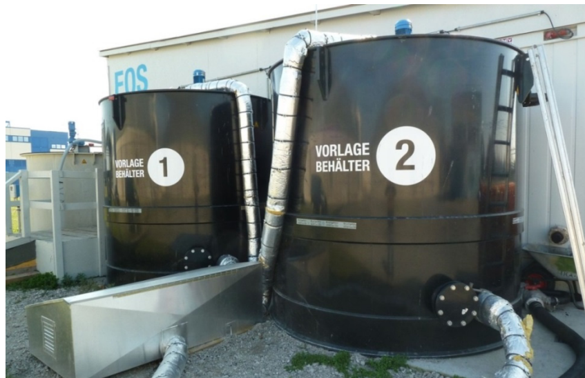
Abbildung 45: Vorlagebehälter 1 und 2 (Speicherbehälter für Rohschlamm) (Aufnahmedatum: 11.03.2014)
