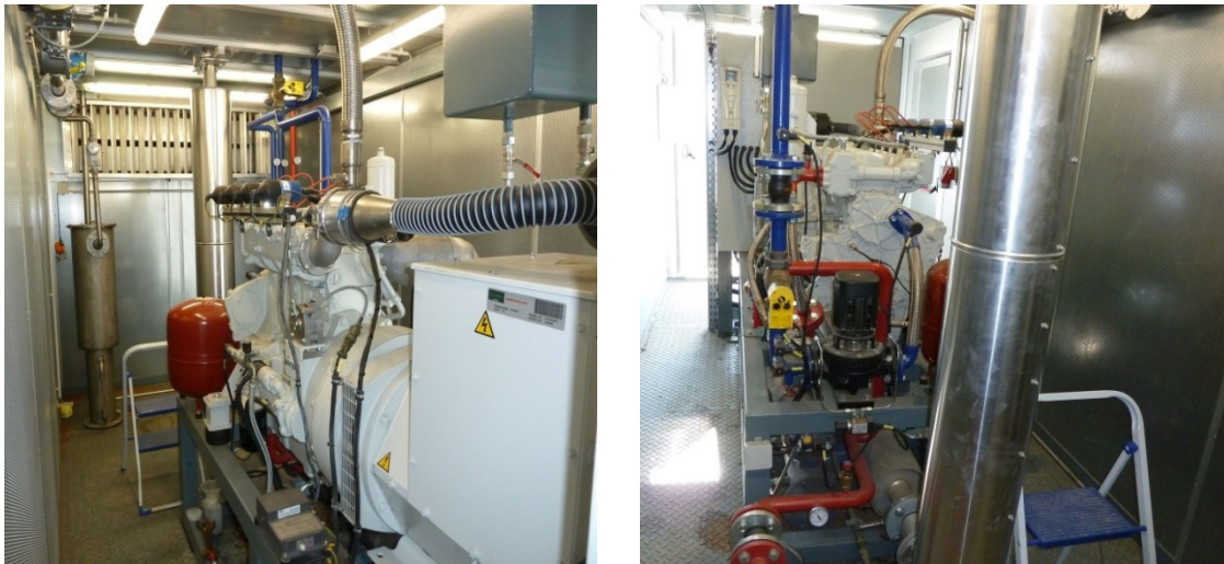
Abbildung 58: BHKW: Innenansicht; links: Blick in den Container; rechts: Blick aus dem Container (Aufnahmedatum: 11.03.2014)
