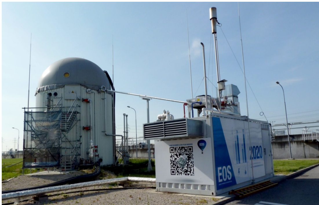
Abbildung 49: Versuchsanlage, Außenansicht: Faulbehälter und BHKW (Aufnahmedatum: 17.04.2013)
