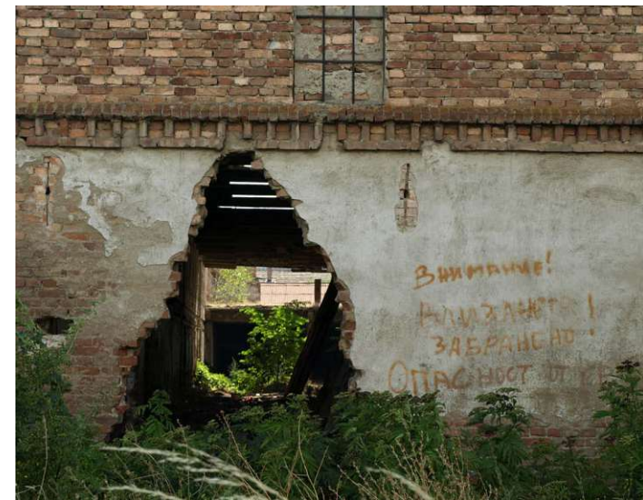
Abb. 105: Ostfassade, Warnung: „Achtung! Betreten verboten! Einsturzgefahr.“
