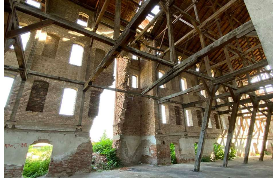
Abb. 63: Fehlstellen im Mauerwerk und fehlende Stützen (2021)
