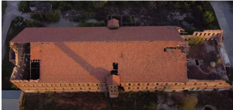
Abb. 58: Luftaufnahme, Schäden an der Dachhaut
