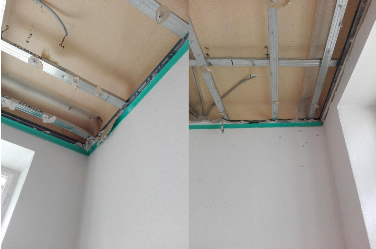
Abb. A.13: Foto des Quellraums vor Messung 07, Zustand der abgehängten Decke
