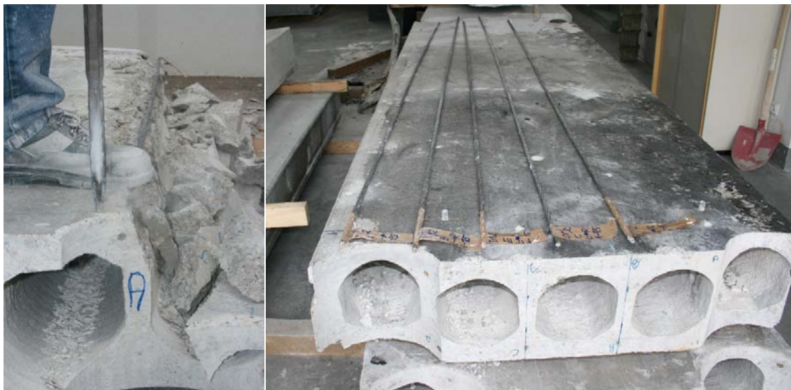
Abbildung 8.8: Ausbau der Spannkabeln mittels Schlagbohrhammer zur mikroskopischen Untersuchung und zur Durchführung weiterer Belastungstests
