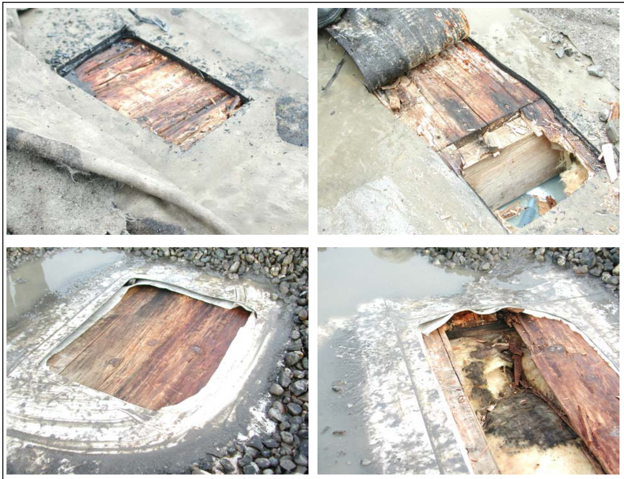
Abbildung 1.4: typische Schadensbilder von nicht hinterlüfteten Flachdächern mit Dämmung in der Trägerebene
