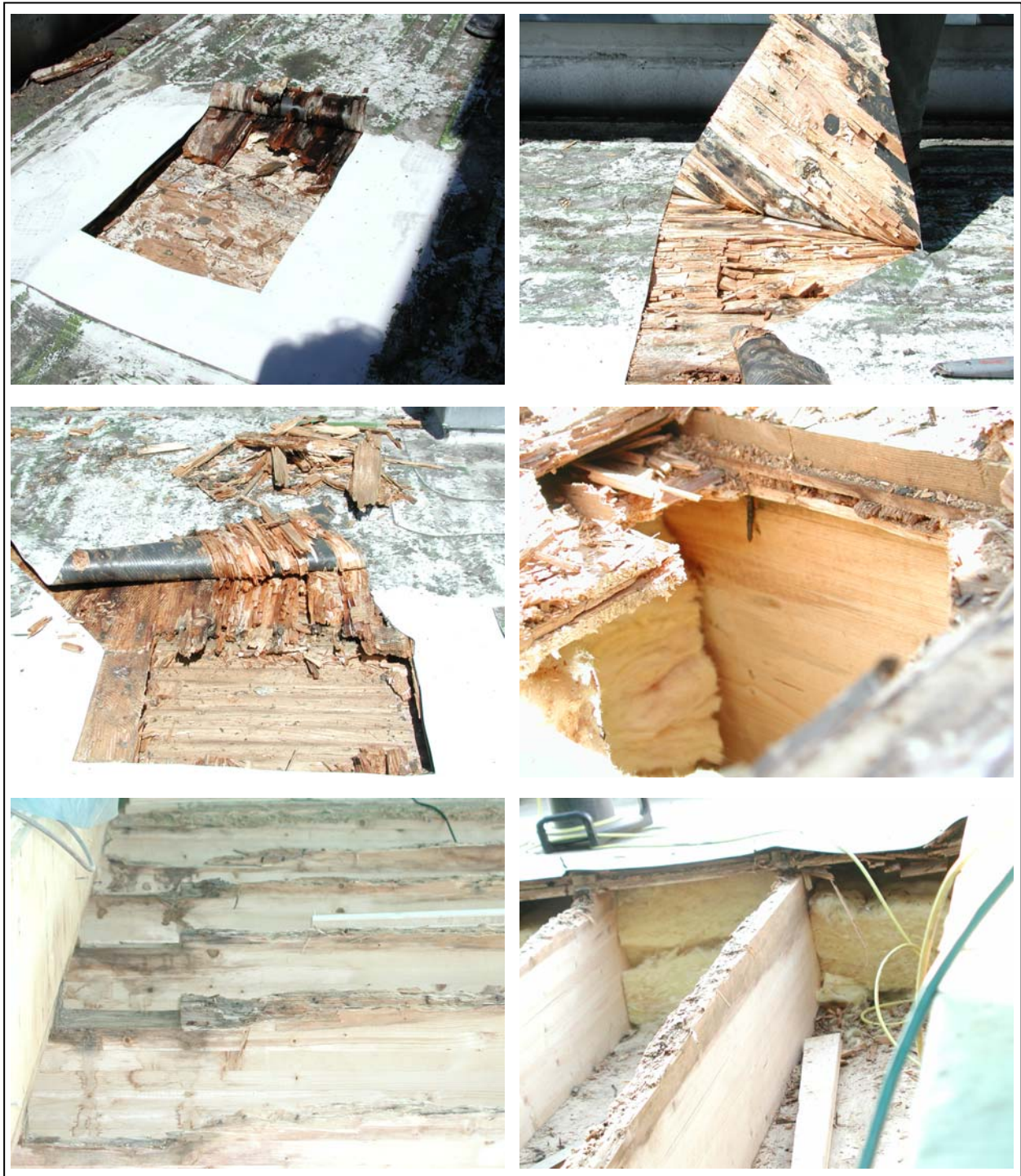
Abbildung 1.3: typische Schadensbilder von nicht hinterlüfteten Flachdächern mit Dämmung in der Trägerebene
