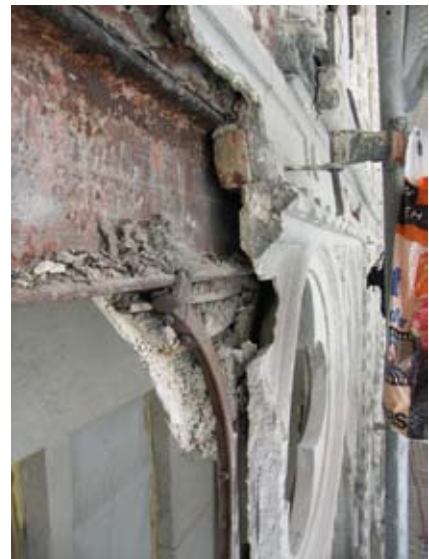
Abb. 5.64-65: Schadensbilder an der Fassade
