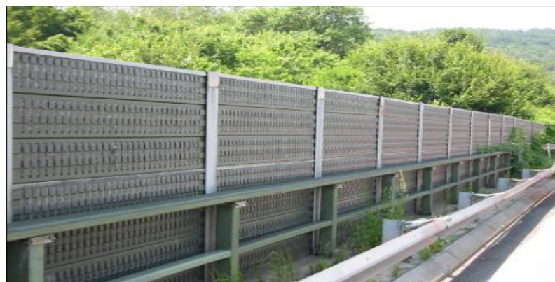
Abbildung 44: Lärmschutzwand aus Recyclingkunststoff [32]
