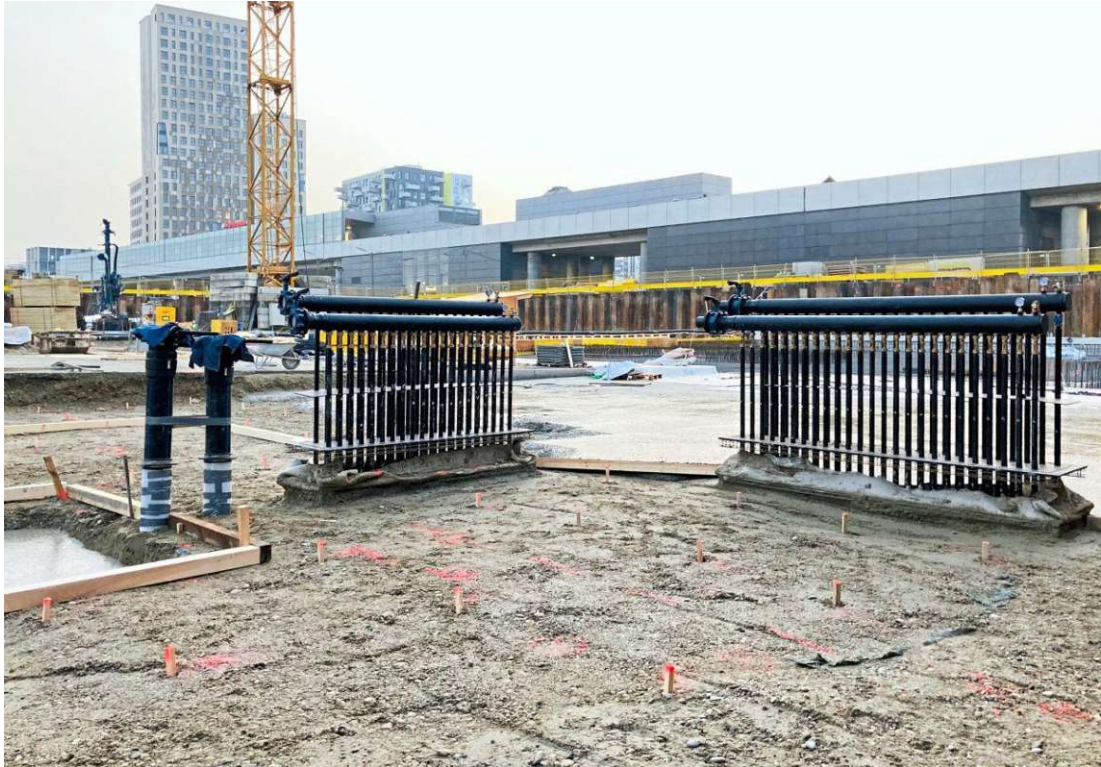
Abbildung 10: Erdsondenarbeiten in der Seestadt H6, Quelle: BCE Beyond Carbon Energy Holding GmbH, 1020, Stella-Klein-Löw Weg 8
