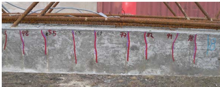
(b) Gerissener Stahlbetonquerschnitt
