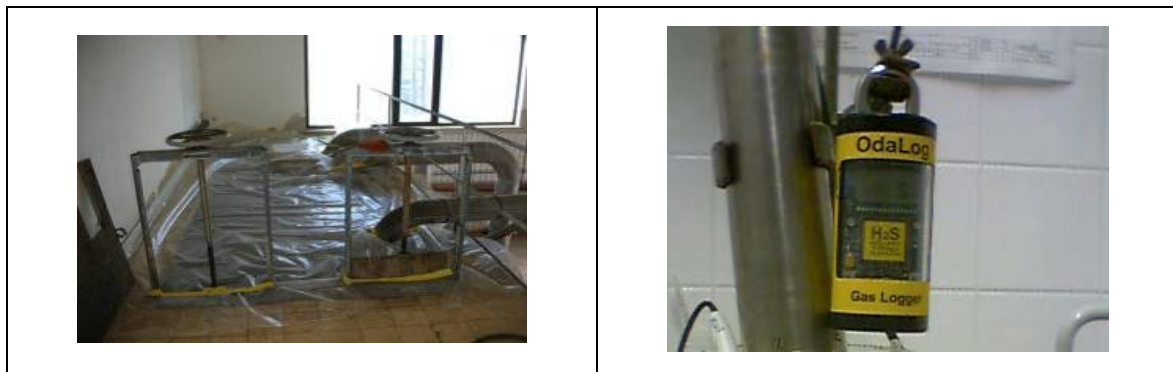
Abbildung 17: Abgedeckter Übernahmeschacht (links) und amperometrisches Sulfidgas-Messgerät (rechts)
