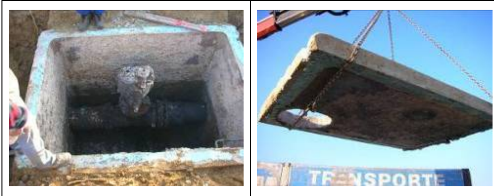
Abbildung 30: Korrosionsschäden beim Leitungshochpunkt des Druckleitung Rusterberg (Matsché und Saracevic, 2007 b)
