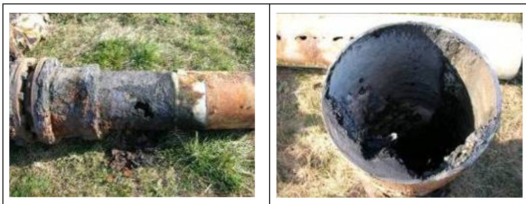
Abbildung 27: Korrosionsbeschädigungen Druckleitung Rusterberg (Matsche und Saracevic, 2007 b)
