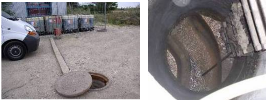
Abbildung 58: Dosierstelle Freispiegelleitung Guntramsdorf
