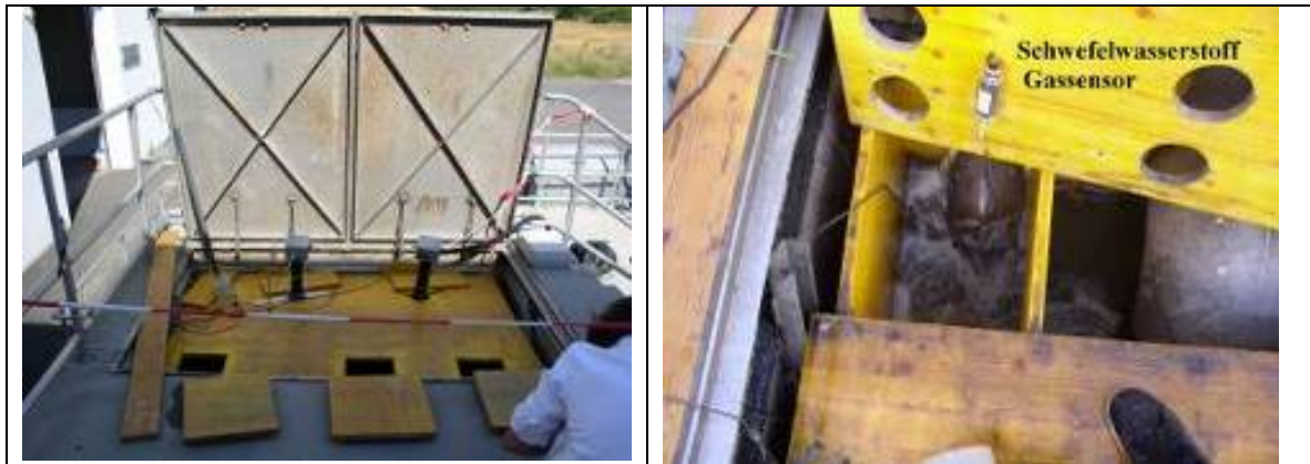
Abbildung 49: Adaptierte Übernahmebauwerk bei RHV NSW (li) mit installiertem Sensor für \text{H}_2\text{S}_g Messung (re.)
