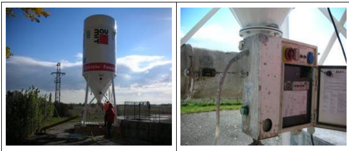
Abbildung 44: Kalksilo (links) und Steueranlage für die Kalkmilchvorbereitung (rechts) beim HPW, Illmitz
