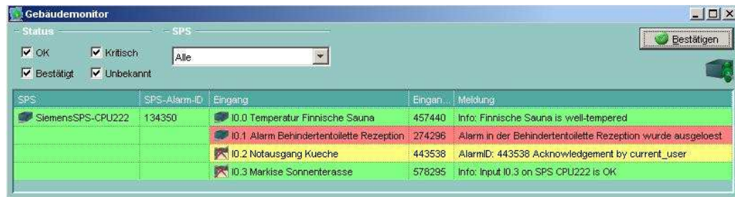
Abbildung 32 HHSC Facility Management Gebäudemonitor
