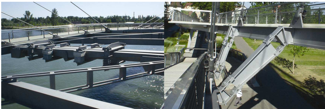
Abb.: 2-27 - Fragwürdige Details einer Fußgängerbrücke
