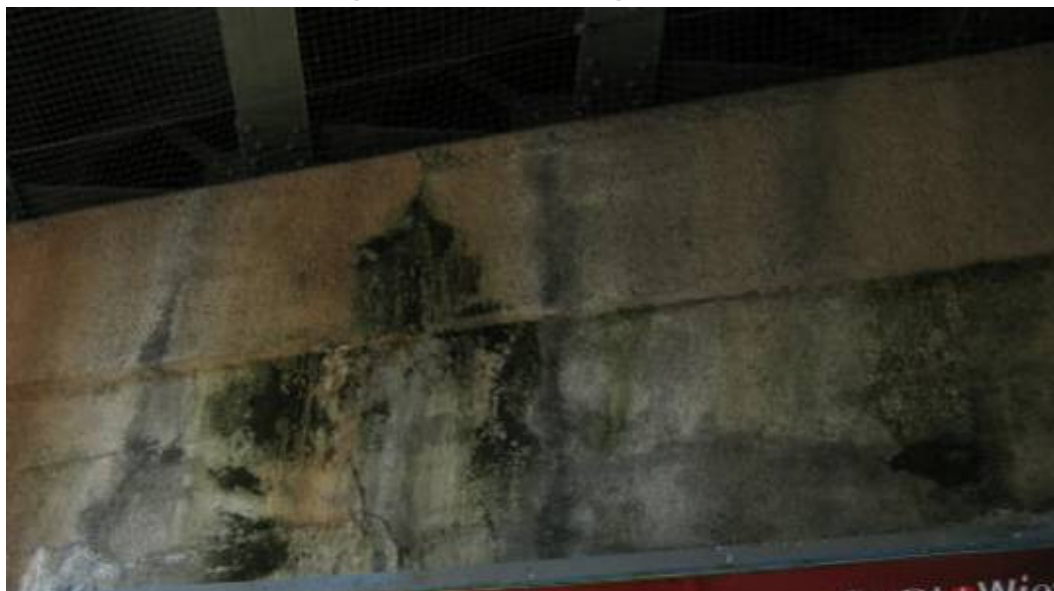
Abbildung 21: Durchfeuchtung und Aussinterung im Widerlagerbereich [2]
