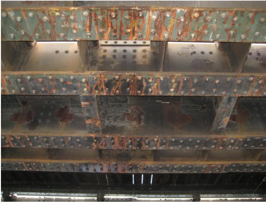
Abbildung 11: Stahltragwerk mit häufigen Anfahrtschäden
