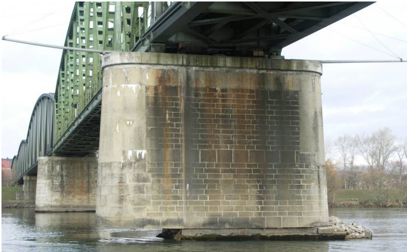
Abbildung 9: Abgescherter Mittelpfeiler der Kremser Donaubrücke
