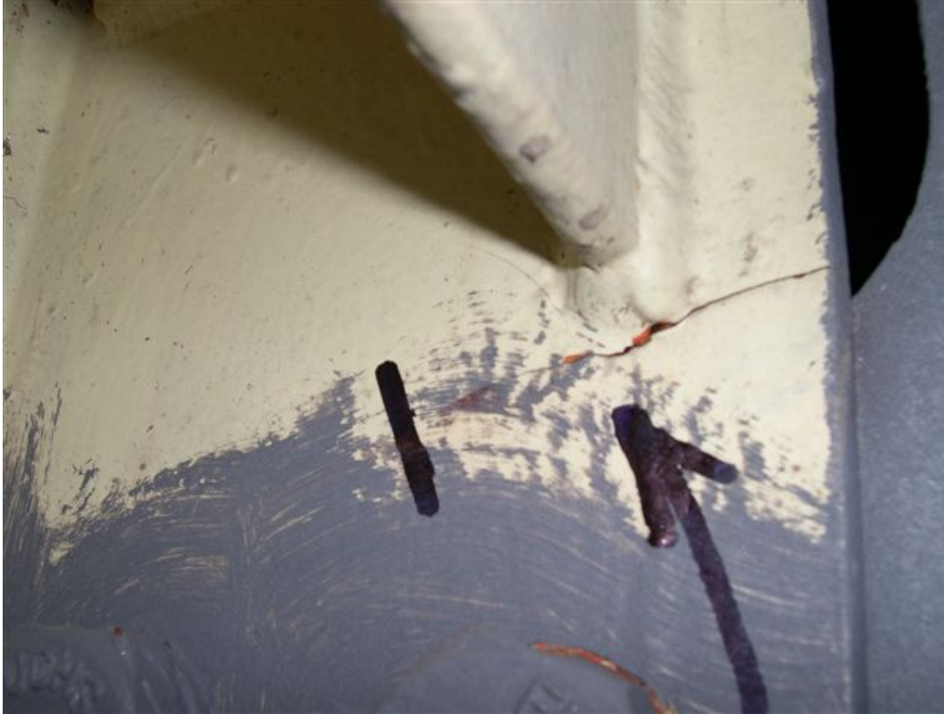
Abbildung 4: Riss im Stahlträger [2]
