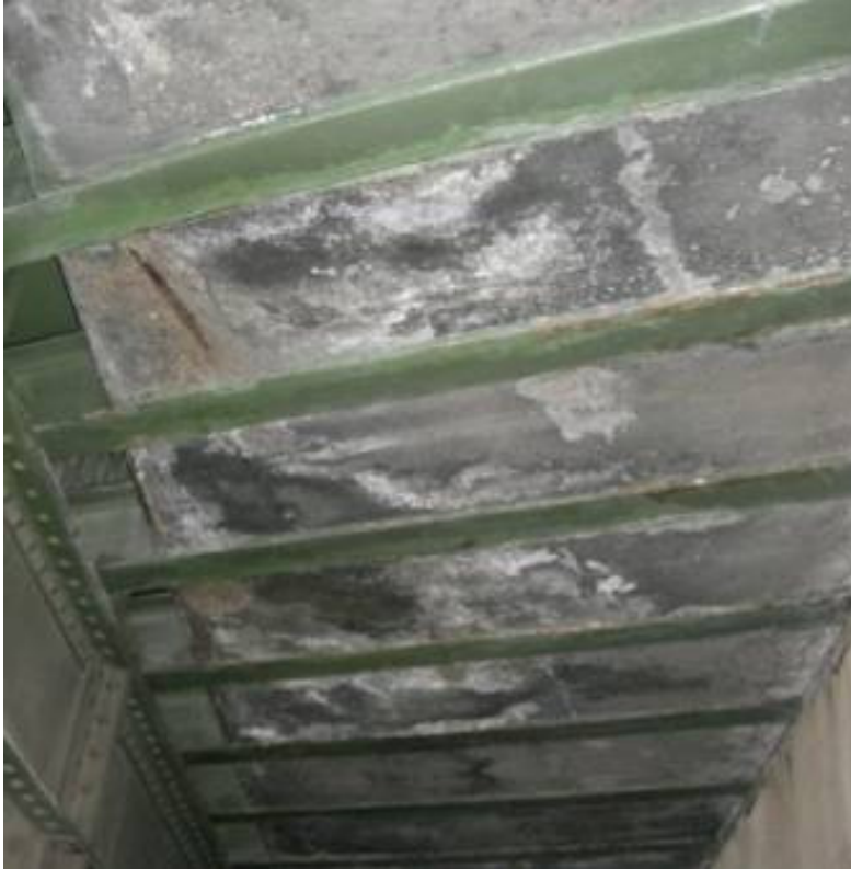
Abbildung 8: Durchfeuchtung und Aussinterungen[2]
