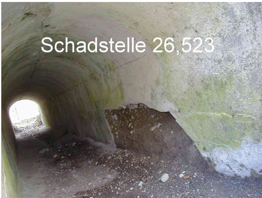
Abbildung 15: Ablösung der Spritzbetonsicherung [1]
