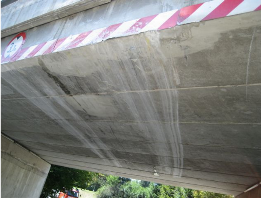
Abbildung 10: Stahlbetonbrücke mit häufigen Anfahrschäden
