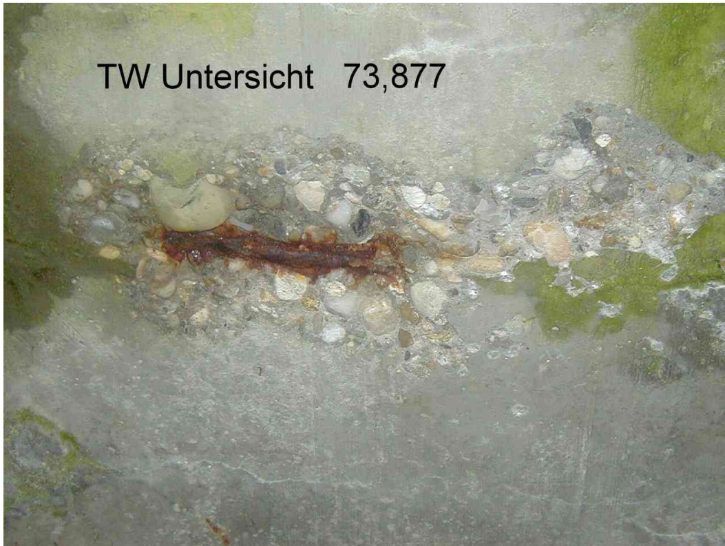
Abbildung 10: Freiliegende Bewehrung teilweise angerostet [1]
