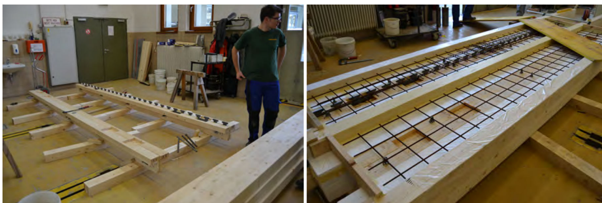
Abb. 5.4: Zwischenschritte in der Fertigung der Träger, links - Träger vor Aufbau der Schalung, rechts - Träger mit aufgebauter Schalung und verlegter Bewehrung [2]
