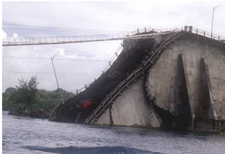
Abb. 1.3: Einsturz der Koror-Babeldaob Brücke [38]
