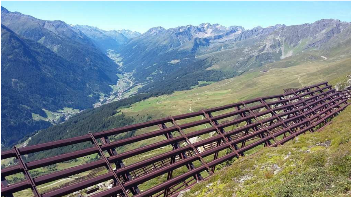
Abbildung 24: Lawinenanbruchverbauung durch Stahlschneebrücken - Flunglawine Tirol (eigene Aufnahme August 2017)
