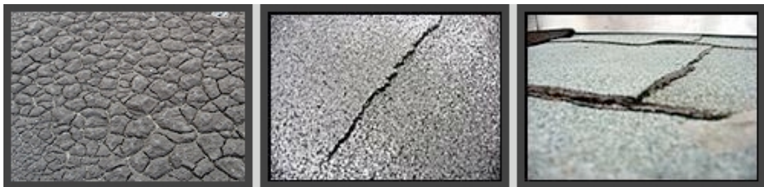
Abbildung 3.13: Beispielbilder für Rissbildung im Bitumen [DIM09]
