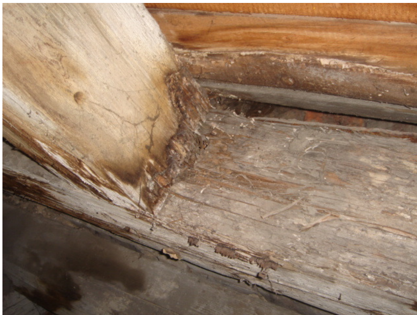
Abbildung 29: Holzfäulnis eines Auswechslungsbalkens und Sparrens im Bereich des Fußpunktes
