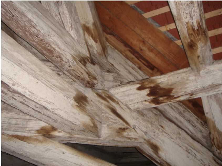
Abbildung 28: Vereinzelt deutlich begrenzte Stellen der Holzverfärbungen
