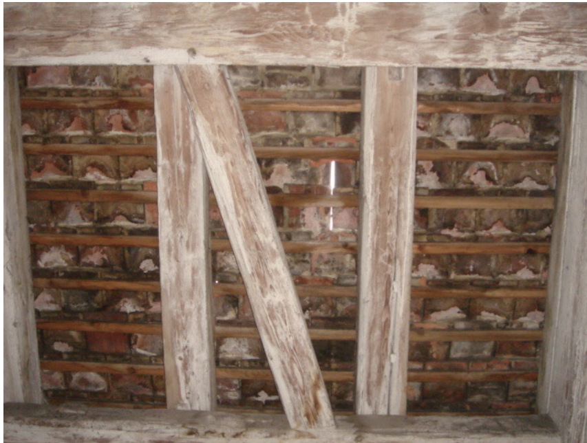
Abbildung 26: Undichte Stelle in der Dachhaut
