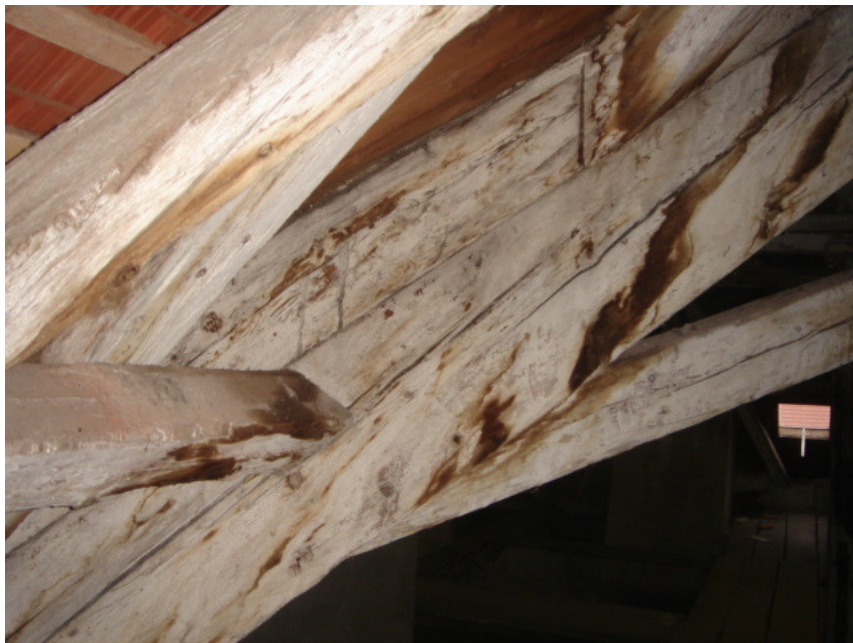
Abbildung 27: Wasserspuren in Form von Verfärbungen an der Konstruktion
