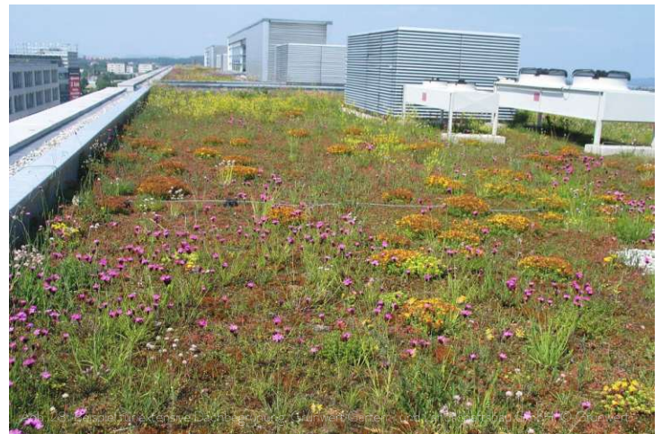
Abb. 27: Beispiel für extensive Dachbegrünung. Grünwert Garten- und Landschaftsbau GmbH. © Grünwert.
