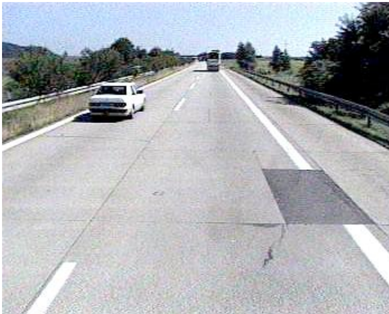
Abbildung 28: Beispiel für das Schadensbild „Flickstellen und bituminöser Teilersatz“ gemäß ZTV-ZEB [27]
