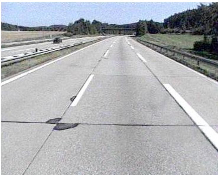
Abbildung 26: Beispiel für das Schadensbild „Eckabbrüche“ gemäß ZTV-ZEB [27]
