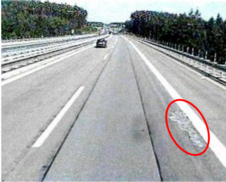
Abbildung 23: Beispiel für das Schadensbild „Ausbrüche“ gemäß ZTV-ZEB [27]
