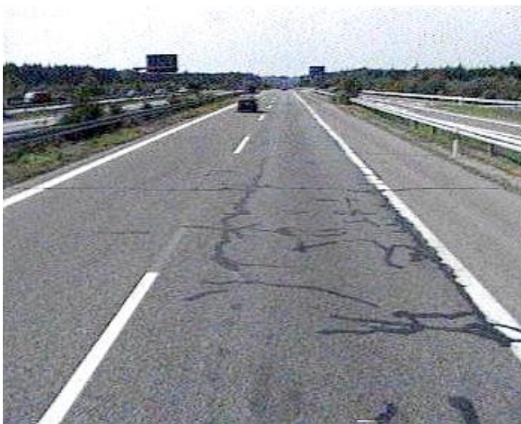
Abbildung 21: Beispiel für das Schadensbild „Risse“ gemäß ZTV-ZEB [27]
