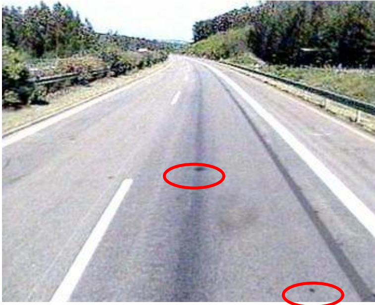
Abbildung 24: Beispiel für das Schadensbild „Bindemittelanreicherung“ gemäß ZTV-ZEB [27]
