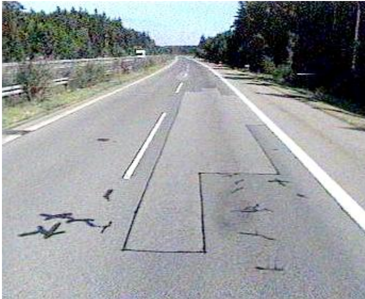
Abbildung 22: Beispiel für das Schadensbild „Flickstellen“ gemäß ZTV-ZEB [27]
