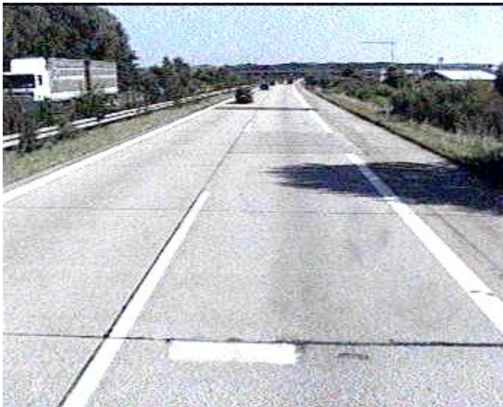
Abbildung 27: Beispiel für das Schadensbild „Kantenschäden“ gemäß ZTV-ZEB [27]
