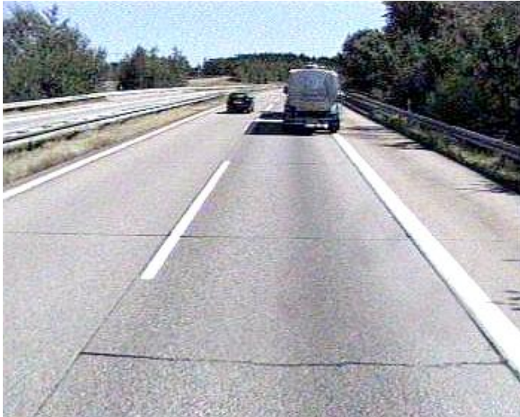
Abbildung 25: Beispiel für das Schadensbild „Längs- und Querrisse“ gemäß ZTV-ZEB [27]
