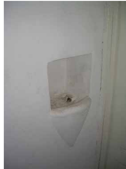
Abbildung 75 li.: Wasserzuleitung im Stiegenhaus
