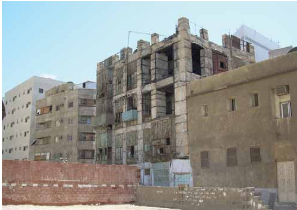
Abbildung 139: Brandruine in Jeddah
