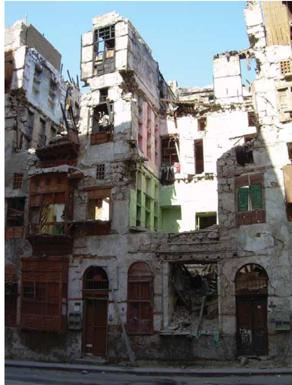
Abbildung 200: verfallenes Haus in Altstadt
