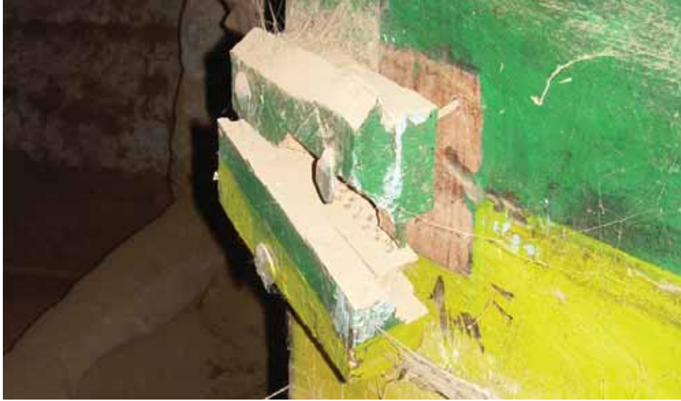
Abbildung 98: Fallstiftschloss an der Tür zu einem Lagerraum im ersten Obergeschoß Lediglich die Lagerräume waren von aussen versperrbar. Alle anderen Türen, auch die Eingangstür waren bei den vermessen Gebäuden lediglich mit einem Riegel gesichert.
