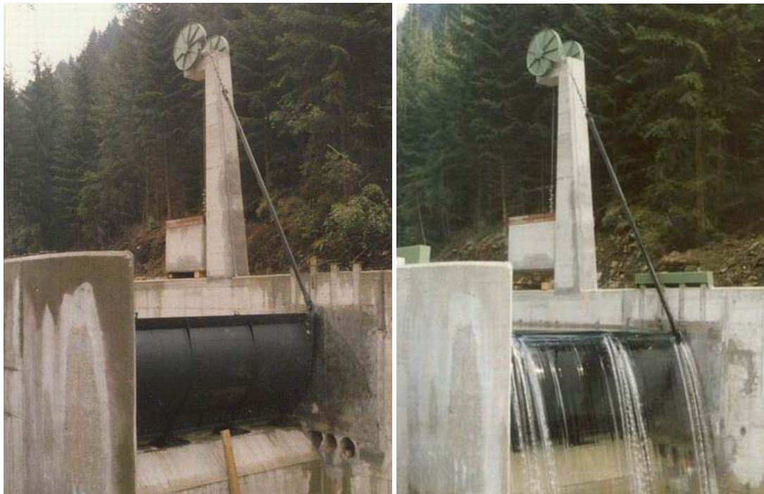
Abbildung 4.6 Beispiel für Wehrklappe als Gegengewichtsanlage [KW Trattlerhof, bei Bad Kleinkirchheim, Kärnten; RADHUBER CONSULTING 2005]
