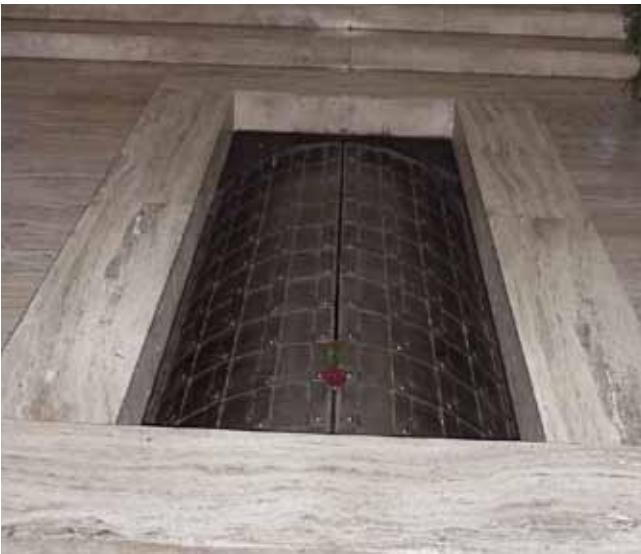
Abb. 49: Metallklappe über der Absenkung
