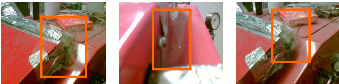
Abbildung 6-17: Dokumentation des Rauchgasaustrittes an der Fülltüre des Kessels
