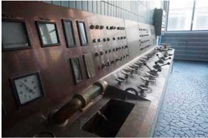
Abb. 243: Schaltzentrale im EG
