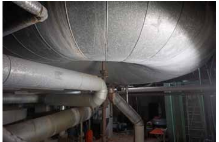
Abb. 246: Untersicht der Kupferkessel im Kellergeschoss
