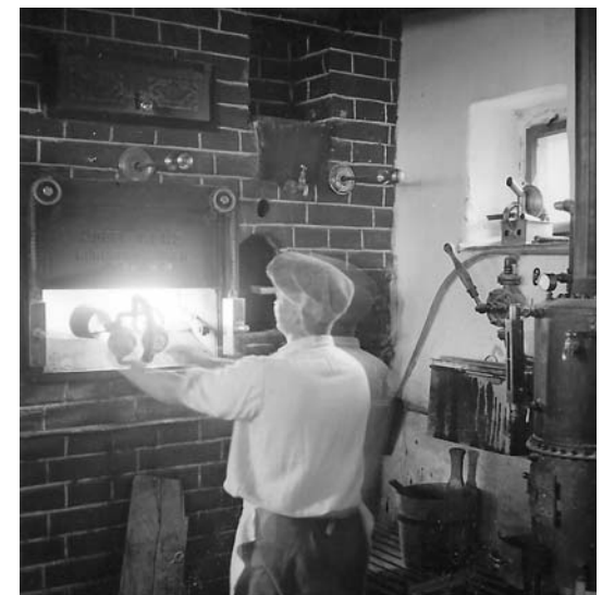
Abb. 58: Ölfuerung beim Anheizen des Backofens
