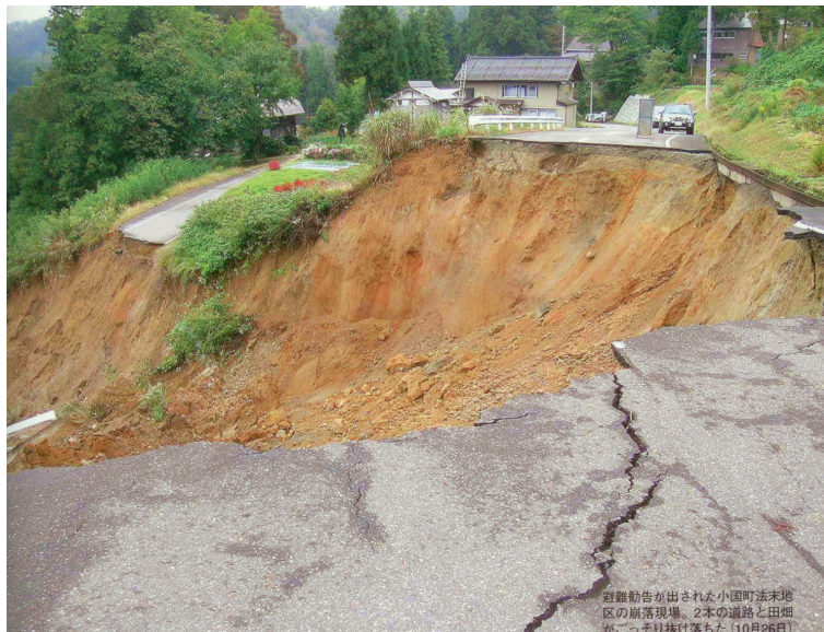
Abbildung 05: Hangrutschung Niigata Erdbeben 2004
