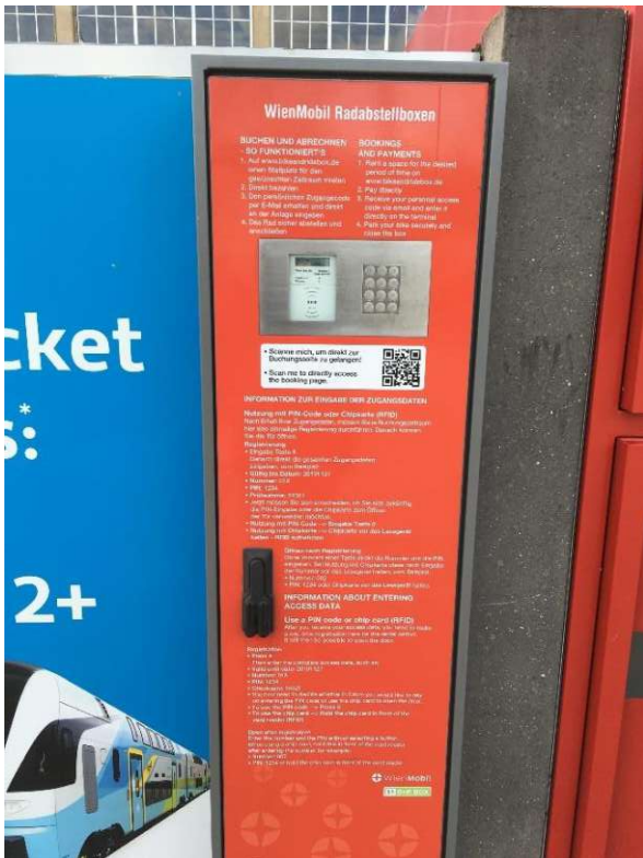
Abbildung 48: Bike-Box-Automat inkl. Anleitung (Westbahnhof)
