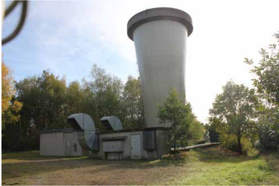
Abb. 65: Hauptlüftergebäude mit Diffusor im nördlichen Bereich des Grundstücks
