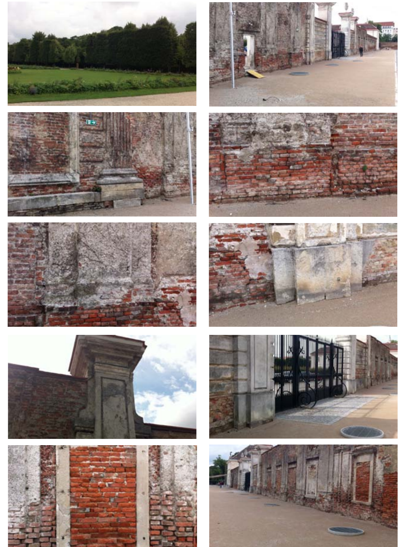
Abbildung 21: Baufällige Mauer im Augarten - Screenshots aus Video-Anwendungsszenario des Geodäten
