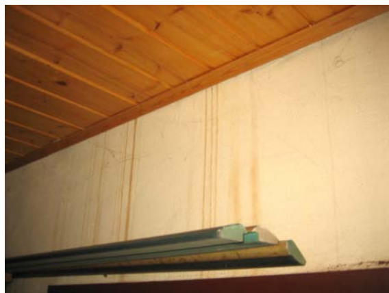
180 Schaden: eindringende Feuchtigkeit
