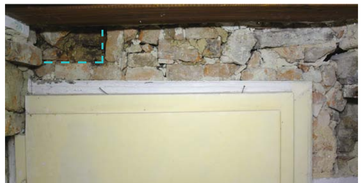
157 Putzfenster 4D Wand E, markierter Balkenkopf
