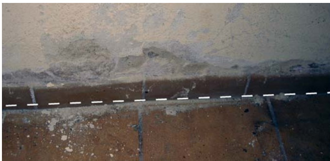
Unebenheiten im Sockelbereich 123
