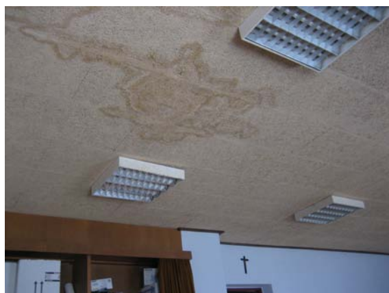
181 Schaden: durchfeuchtete Decke
