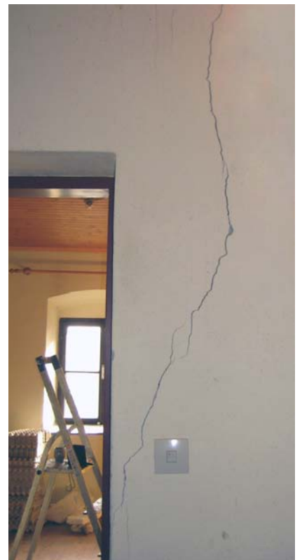
128 Risse Wand 09D, Blick von R09
