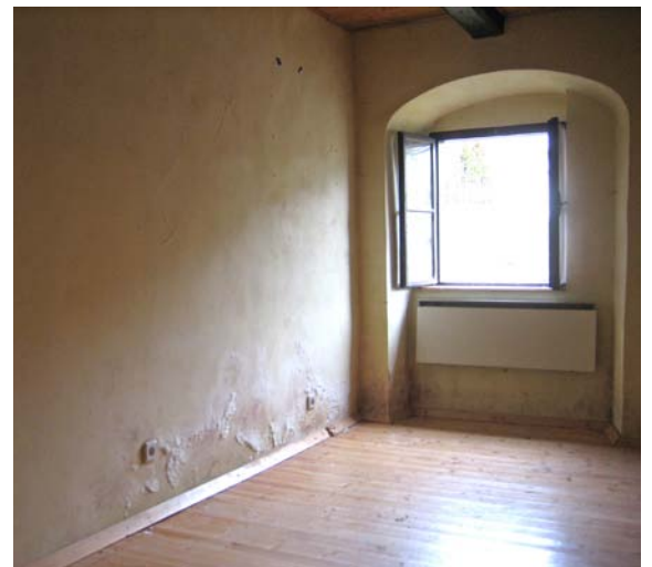
184 Nordfassade mit Querwand, Feuchteschäden
