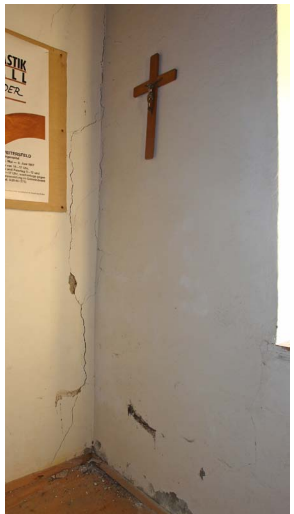
190 Rissbildung in Wandecke
