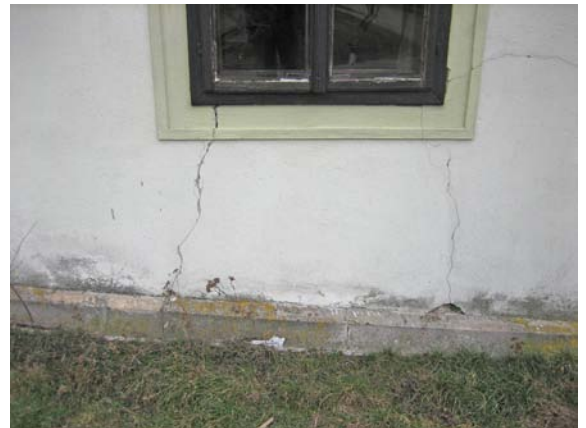
189 Risse bei Wandöffnungen
