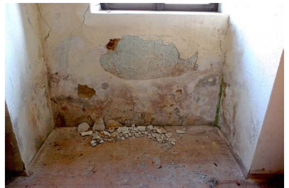
186 Schimmel und Putzfehlstellen
