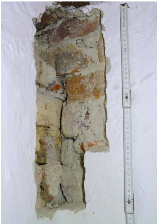
Putzfenster 4C2, Wand B und C 150
