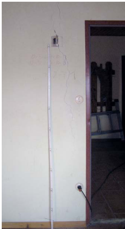
127 Risse Wand 09D, Blick von R11
