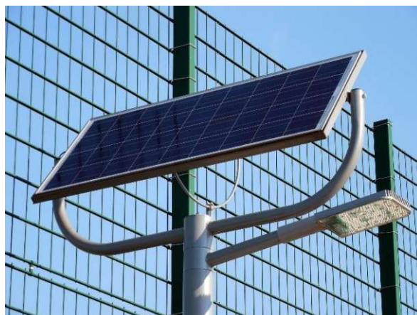
Abb. 35: PV-Anlage auf einer Straßenlaterne; Quelle: pixabay, o.J.
