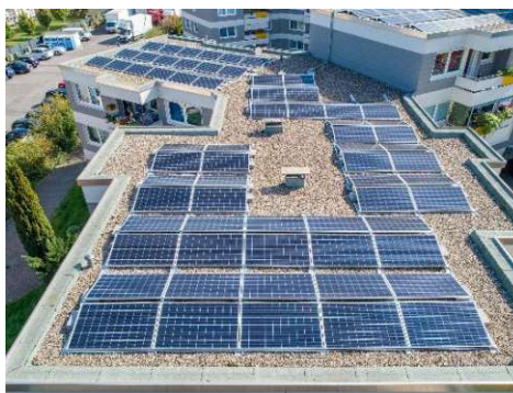
Abb. 33: PV-Anlage auf Flachdach; Quelle: pixabay, o.J.
