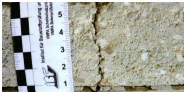
Abbildung 3 Trennriss über die Estrichdicke [21]
