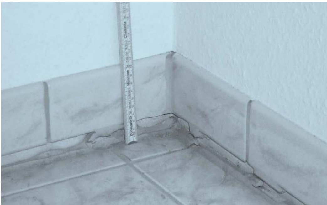
Abbildung 4 Randabsenkung mit konvexer Verformung [16]
