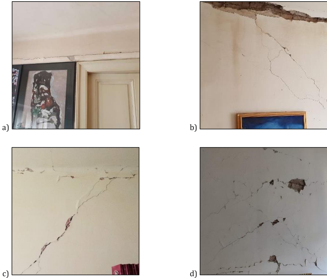
Abbildung 35: Exemplarische Schadensbilder an nichttragender Mauerwerksstruktur mit a) Objekt 1 – Horizontale Risse am Türsturz (S2); b) Objekt 9 – Diagonale Schubrisse sowie Risse im Anschlussbereich der Decke (S2) und (S3); c) Objekt 22 – Diagonale Schubrisse im Mauerwerk (S3) und d) Objekt 32 – Risse im Mauerwerk und an den Anschlussbereichen (S3). Fotos: Mario Todorčić.
