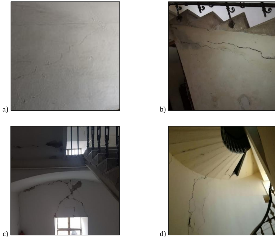
Abbildung 37: Exemplarische Schadensbilder an der Treppenhausstruktur mit a) Objekt 11 – Schubrisse im tragenden Mauerwerk (S1); b) Objekt 35 – Risse Auflagerbereich Treppenkonstruktion (S2); c) Objekt 29 – kreuzförmige Risse im Fenstersturz, Risse im Anschlussbereich Treppenhauswand und Podest (S3) und (S3) und Risse und Abplatzungen an der Unterseite der Laufplatte (S3) und d) Objekt 19 – Zerstörte Kragstufe (S4), Risse im Mauerwerk (S3). Fotos: Mario Todoric.
