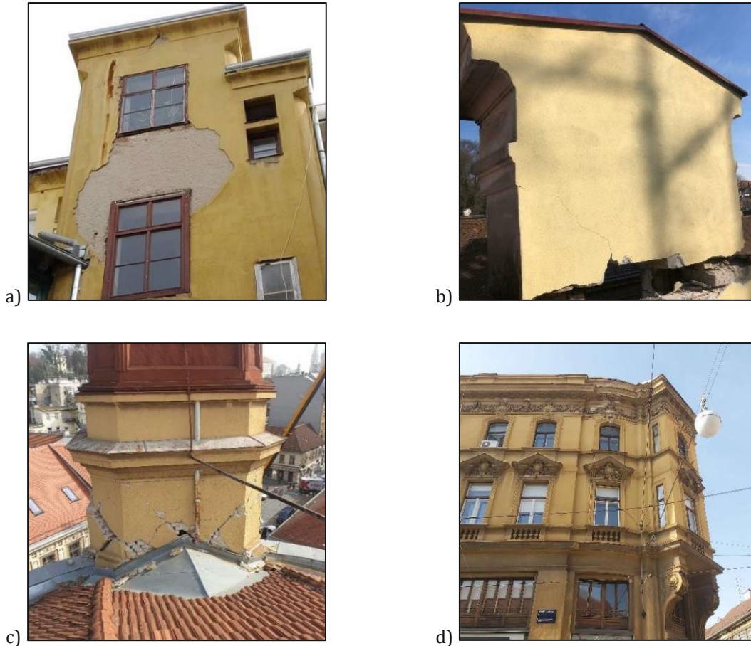
Abbildung 43: Exemplarische Schadensbilder weiterer nichttragender Elemente mit a) Objekt 4 – Beschädigte Fassade und Gesimse (S4); b) Objekt 32 – Aufklappen der Attikaausbildung (S4); c) Objekt 1 – Starke Risse im Auflager des Turmes (S4) und d) Objekt 1 – Turm nach Sanierungsmaßnahme. Fotos: Mario Todorčić (a-c), Autor (d)
