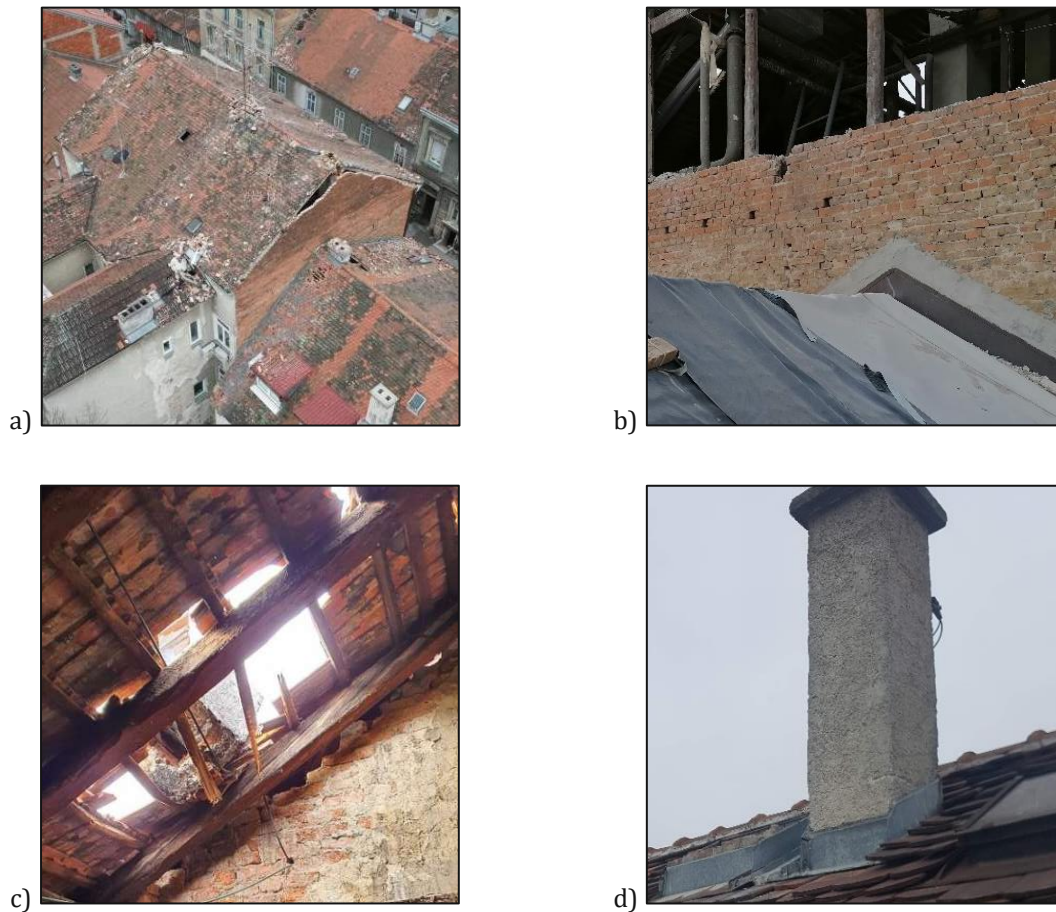
Abbildung 41: Exemplarische Schadensbilder im Gebäudebereich Dachboden/Dach mit a) Objekt 23 – Erdbebenschäden und Folgeschaden am benachbarten Objekt 22 durch das teilweise Herabfallen der Giebelwand und der Rauchfänge (S4); b) Objekt 6 – zerstörte Giebelwand (S4); c) Objekt 18 – Folgeschäden an der Dachkonstruktion (S4) und d) Objekt 29 – Erdbebenschäden an Rauchfängen (S4). Fotos: Mario Todoric
