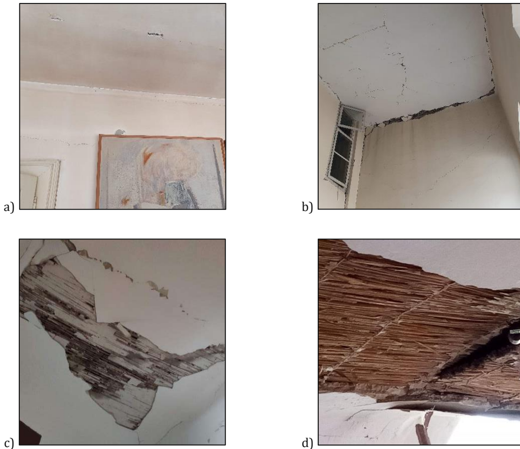
Abbildung 39: Exemplarische Schadensbilder an den hölzernen Deckenkonstruktionen mit a) Objekt 1 – Risse im Anschlussbereich Decke-Wand (S1); b) Objekt 1 – Feinrisse an der Decke (S1), Risse im Anschlussbereich Decke-Wand (S2); c) Objekt 32 - Putzabplatzungen an der Deckenunterseite (S3) und d) Objekt 22 – Putzabplatzungen an der Decke (S3). Fotos: Mario Todorić.
