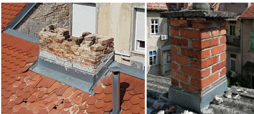
Abb. 24: Erdbebenschäden an gemauerten Schornsteinen (Bildquelle: HCPI-Datenbank [35]).
