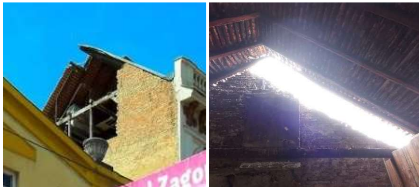
Abb. 25: Erdbebenschäden an Giebelwänden (Bildquelle: HCPI-Datenbank [35]).
