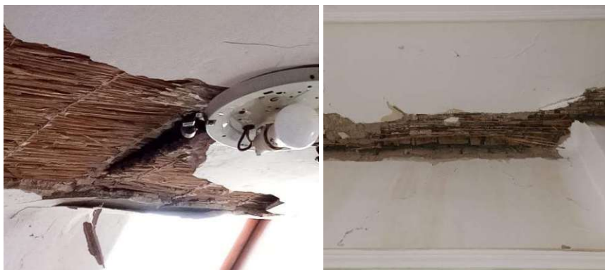
Abb. 23: Erdbebenschäden an Deckenkonstruktionen (Bildquelle: HCPI-Datenbank [35]).
