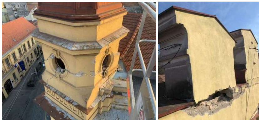
Abb. 27: Erdbebenschäden an dekorativen Elementen (Bildquelle: HCPI-Datenbank [35]).
