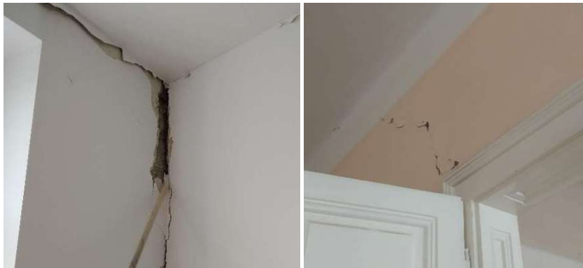
Abb. 26: Erdbebenschäden an nichttragenden Wänden (Bildquelle: HCPI-Datenbank [35]).
