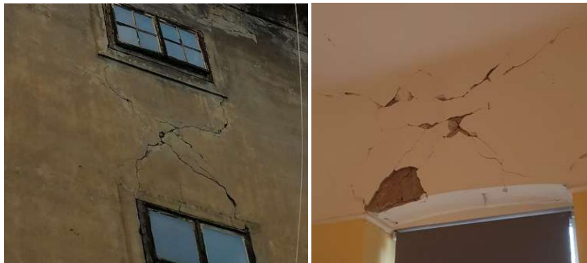
Abb. 22: Erdbebenschäden an tragenden Mauerwerkswänden (Bildquelle: HCPI-Datenbank [35]).
