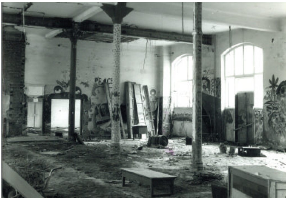
Abb.141 Projektraum in bauflälligem Zustand (1979)
