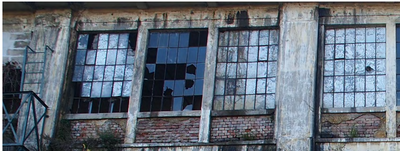
Abbildung 67: Spinnerei Teesdorf, desolate Fensterflächen, Foto
