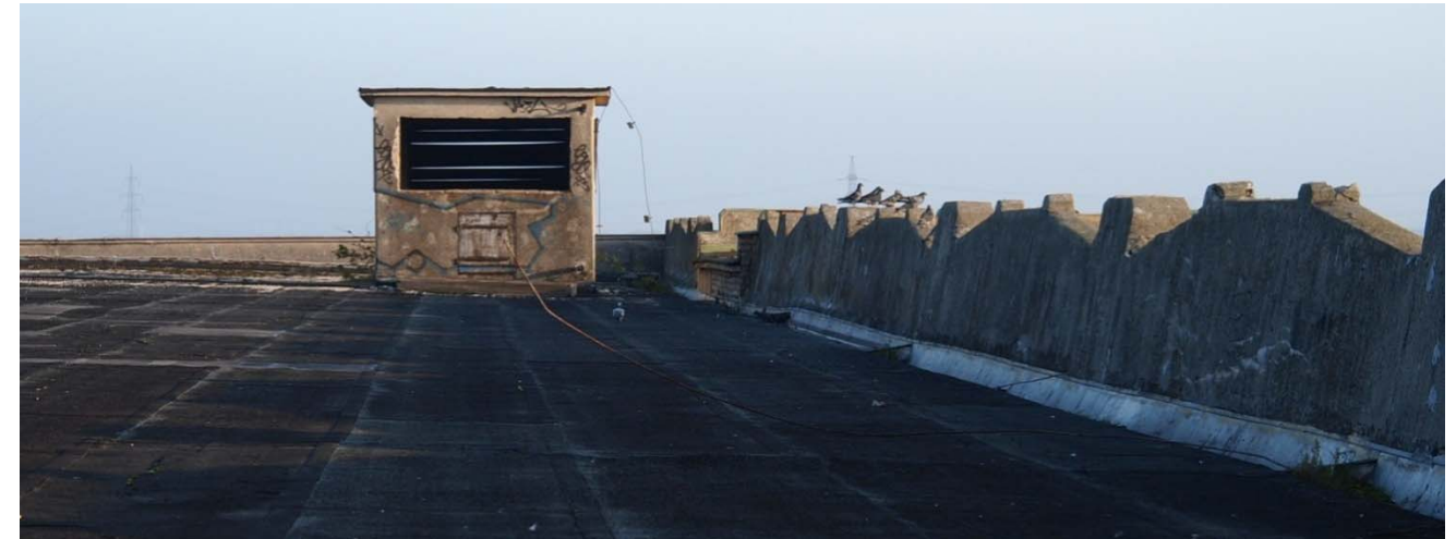
Abbildung 68: Spinnerei Teesdorf, desolate Dachabdichtung und Rinne, Foto
