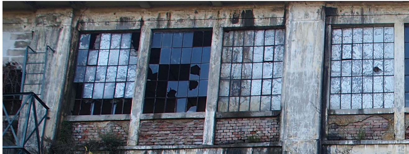
Abbildung 67: Spinnerei Teesdorf, desolate Fensterflächen, Foto
