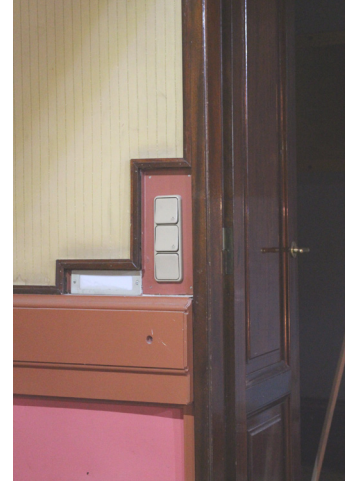
57 – Hermann Czech, „Souterrainlokal Palais Schwarzenberg“, Elektroinstallationen.
