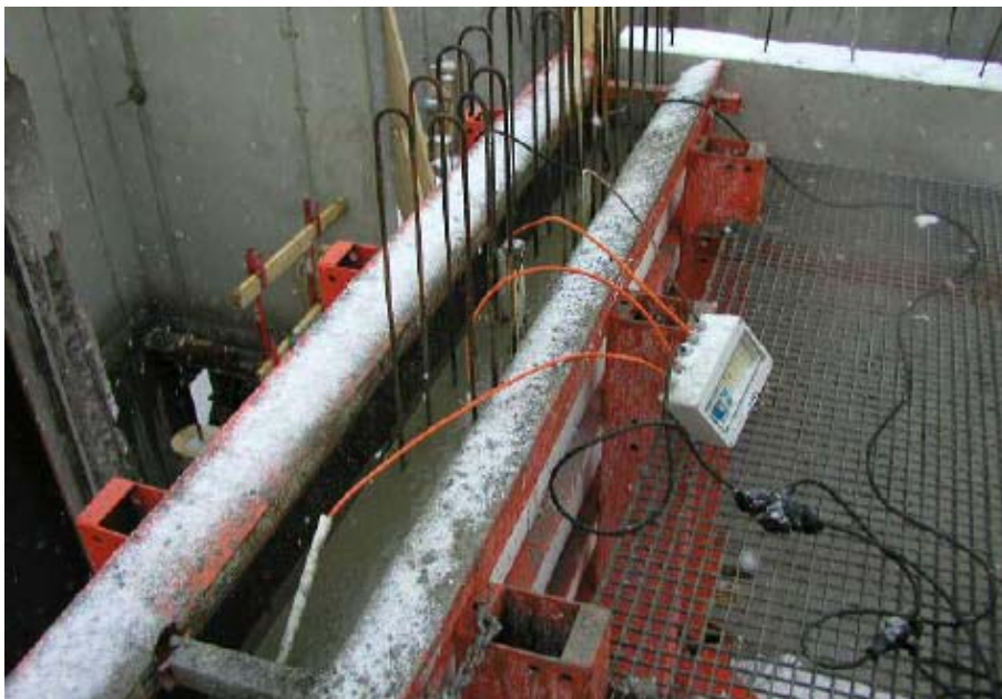
Abbildung 7: Einbetonierte Heizdrähte mit elektronischer Mess- und Steuerungseinheit, Quelle: Rationalisierungs- und Innovationszentrum der Deutschen Wirtschaft e.V.
