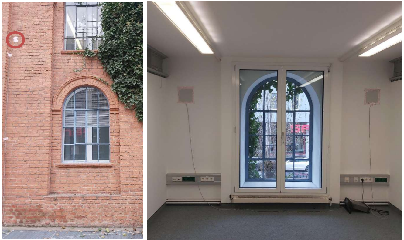
Abb. 9: Messsensoren auf der Außen- und Innenwandseite in der Muthgasse
