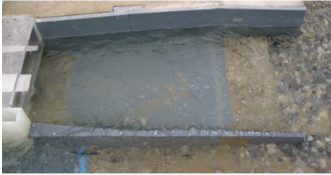
(a) Überströmung der rechten Auslaufmauer
