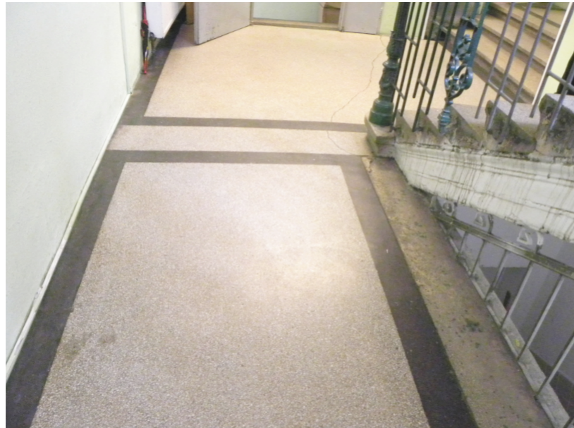
Abb. 11-61: Fotografie Fußboden Schule (2019)
