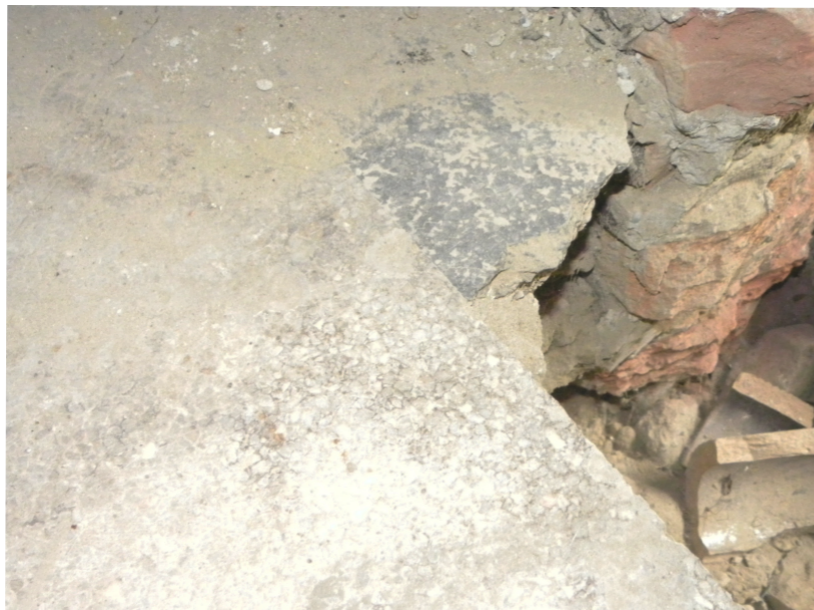
Abb. 11-62: Fotografie Fußbodenreste Synagoge an der Grabungsstätte (2019)
